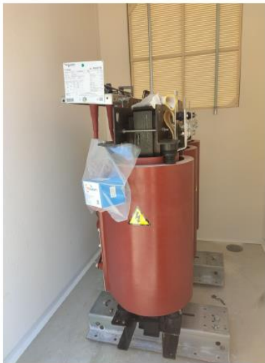
Transformateur poste électrique
