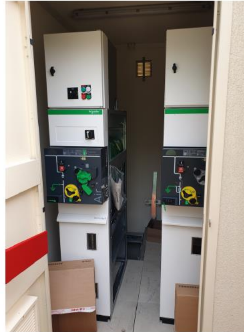
Cellules poste électrique
