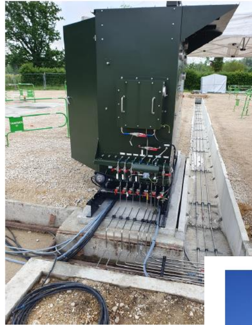
Nouvelle armoire MSP
